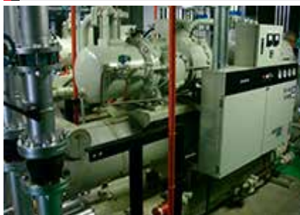
冷凍機保守点検業務
