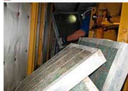
空調機保守管理
