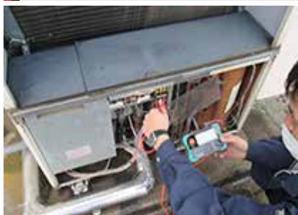
空調機保守管理
