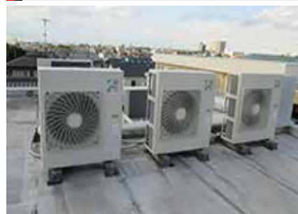
工場用空調設備工事
