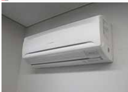
工場用空調設備工事
