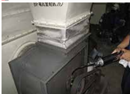
換気設備保守点検業務
