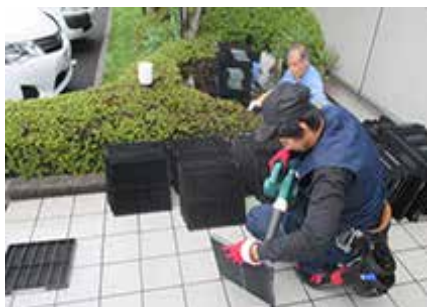
空調機保守管理
