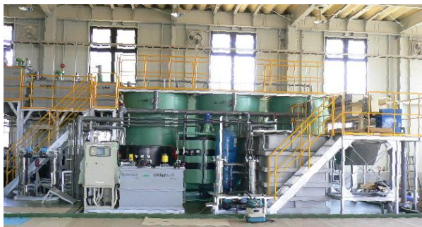
メッキ廃水処理プラント(処理能力: 10m 3 /hr)
